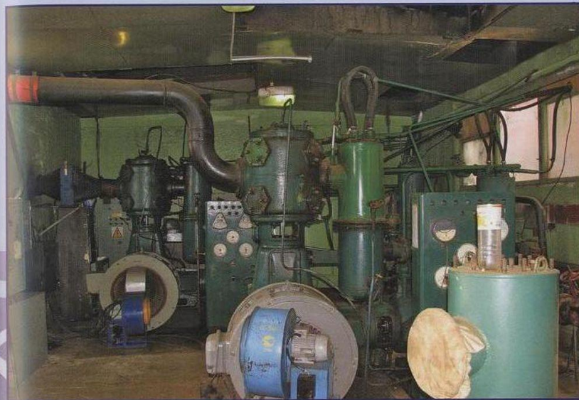
Компрессорная. Подача воздуха на слип и производственные участки.
