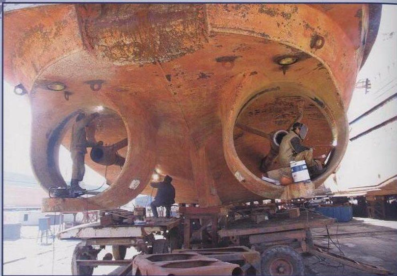
Восстановление коррозированного центрального пояса встроенной в корпус насадки буксира. Наплавка и обработка шлифмашинкой.
